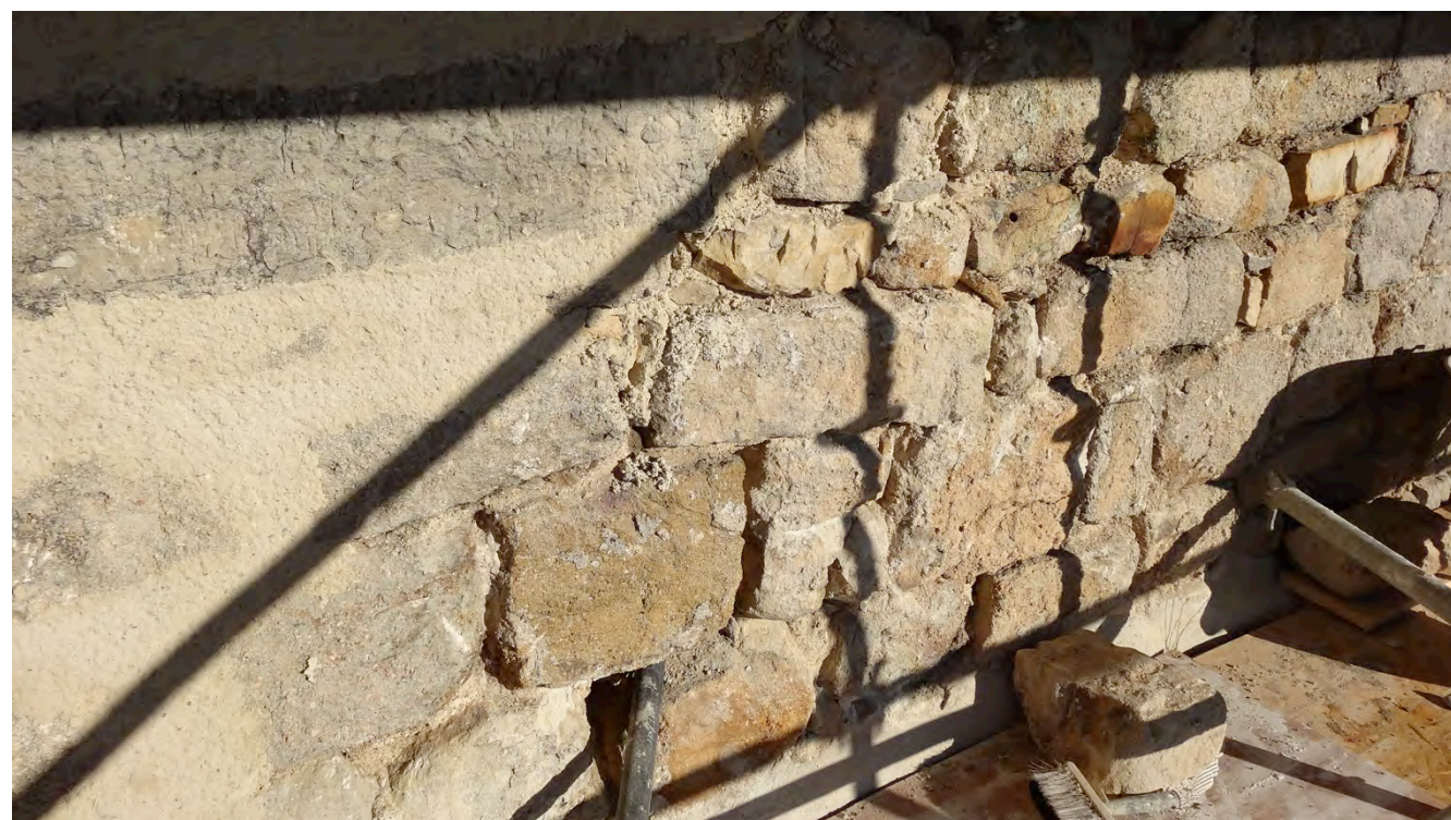
Exemple d'une façade en cours de restauration, à gauche le jointoiment largement beurré, compte tenu de l'état de la pierre, est achevé, au centre les joints dégarnis suffisamment et lavés, à droite le dégarnissage des joints en cours avec le nettoyage de la pierre.
