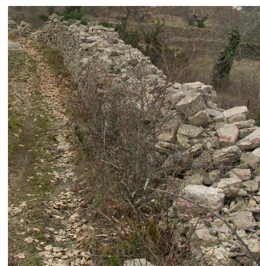
Muret en pierre sèche à restaurer quartier de Veyrune délimitant le chemin public
