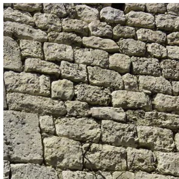
Exemple d'appareillage méritant un jointoiment
