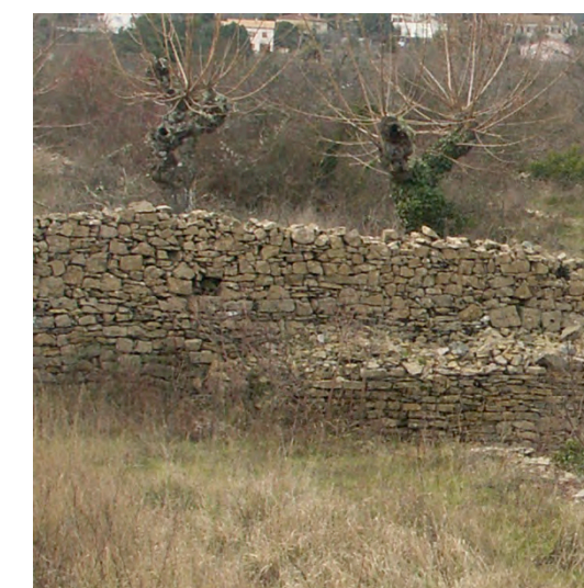
Mur de pierres sèches à restaurer, quartier du Planas entre des parcelles agricoles
