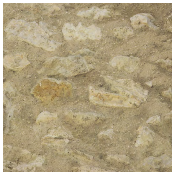
Jointoiment à joints garnis ou à « pierres vues » sur une maçonnerie à en moellons tout venant
